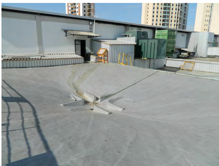
Figura 50 - Cobertura para captação de água da chuva.
