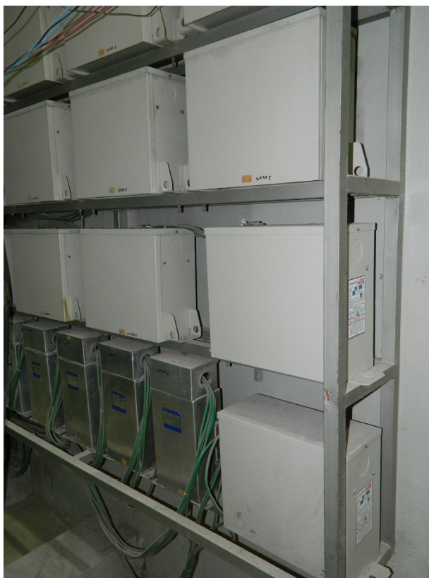
Figura 52 - Banco de capacitores.
