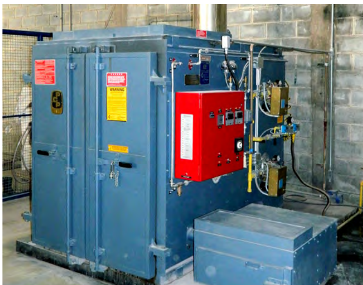
Figura 42 - Queimador de telas com "afterburners".
