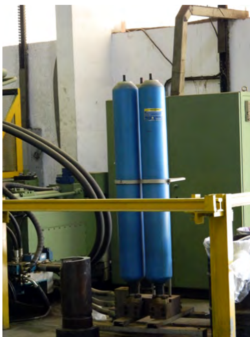
Figura 44 - Acumuladores de pressão.
