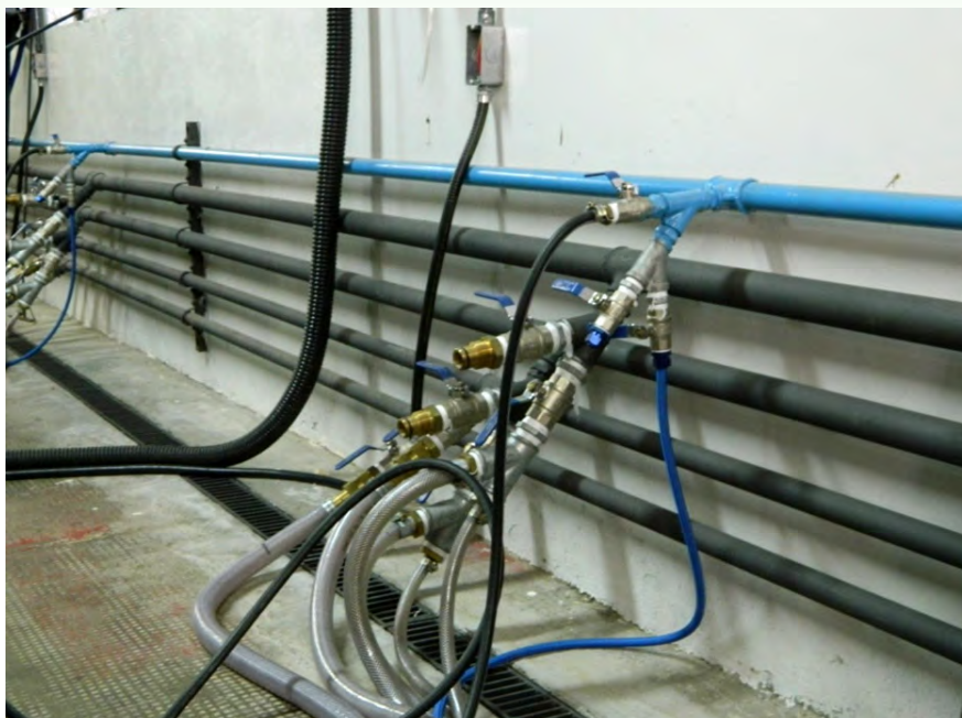
Figura 53 - Organização de tubulação.
